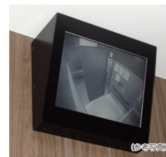
EVホールモニター
