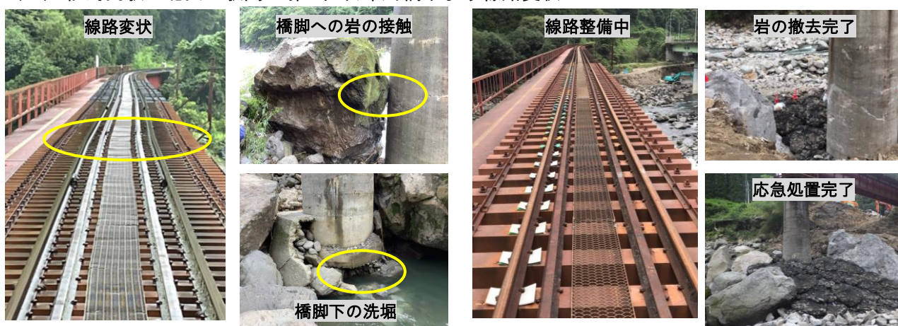
被災時の状況
