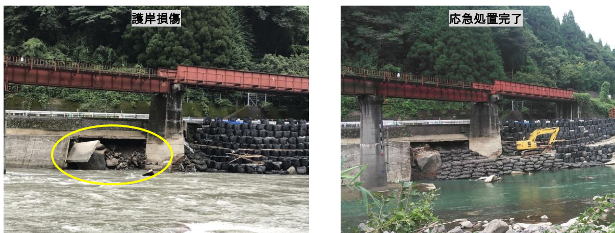
被災時の状況
