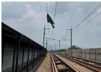
架線に付着する飛来物（防草シート）
