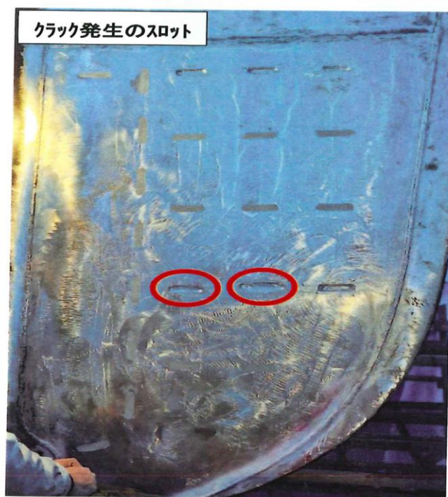
【図 12 : 2024 年 1 月に船首右舷側外板のスロット溶接部分に確認されたクラックの発生箇所】
