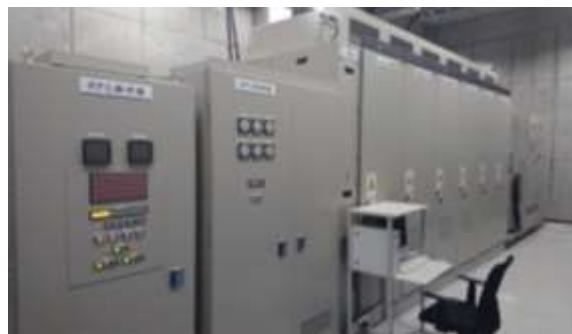
電力融通装置写真
