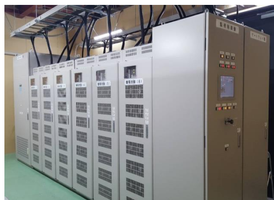
唐津変電所電力貯蔵装置写真
