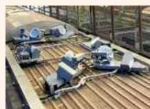
屋根上への搭載状態
