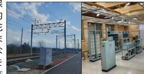
〔花園実習線設備〕
