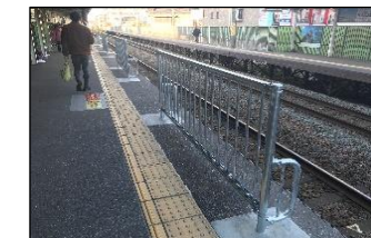
〔ホーム固定柵(笹原駅)〕
