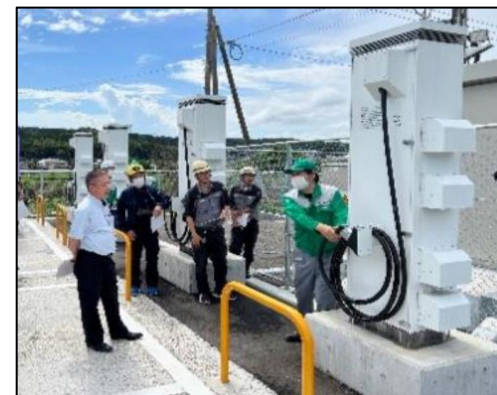
〔BRT設備取扱い訓練〕
