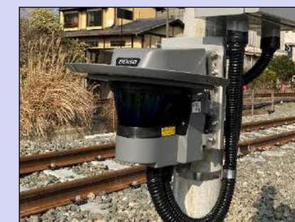
〔踏切障害物検知装置(2D式)〕
