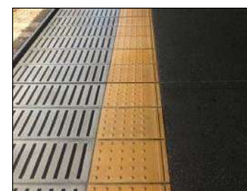
〔内方線付き点状ブロック〕
