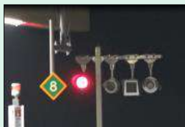
〔ホーム下への転落を検知し赤色灯が点滅した状態(写真上)〕
