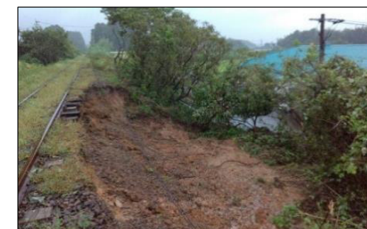
[肥薩線 築堤崩壊]
