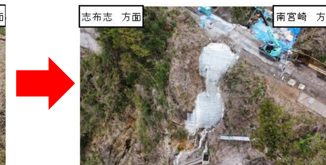
[日南線 築堤崩壊]
