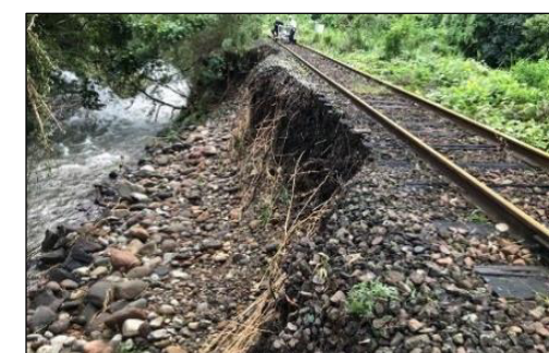
[吉都線 築堤崩壊]
