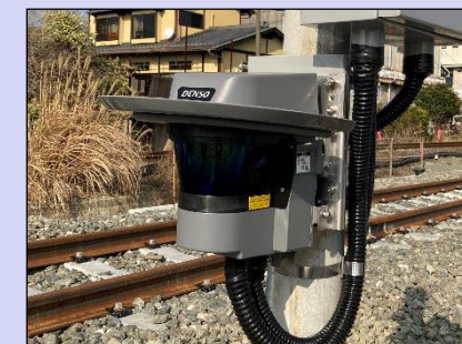
〔踏切障害物検知装置(2D式)〕
