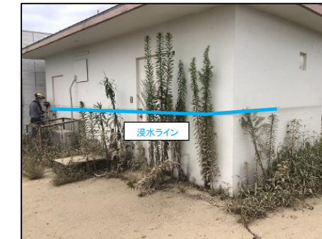
〔信号機器室浸水〕
