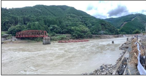
[橋りょう流失]
