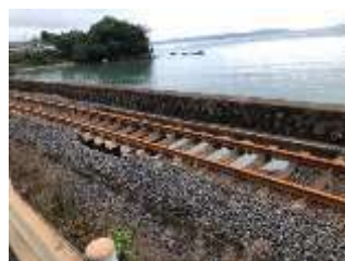
〔護岸・路盤流出〕
