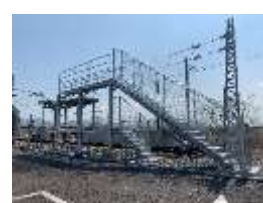
〔車両屋上機器点検台〕
