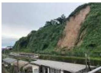
〔切取斜面の崩壊〕
