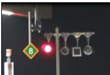
〔ホーム下への転落を検知した状態〕 (赤色灯点滅(写真上))
