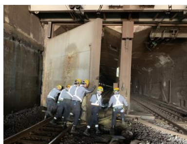
[トンネル内防水扉の閉扉]
