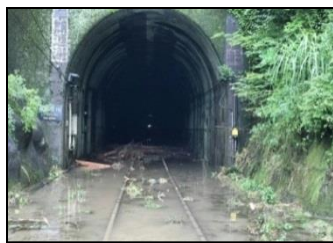
〔トンネルへの土砂流入〕
