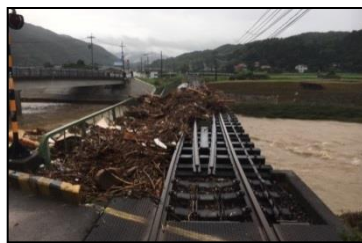
〔橋りょうの橋脚傾斜〕
