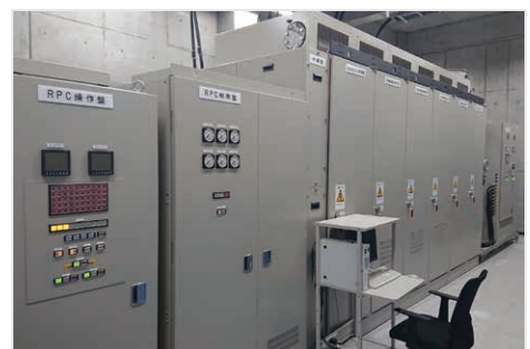
電力融通装置
