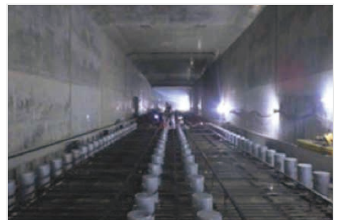
軌道スラブ内のコイルバネ(折尾駅)
