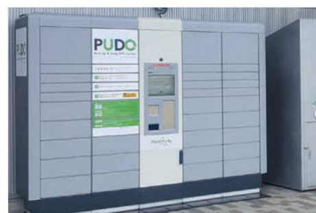
「オープン型宅配便ロッカー」の設置
