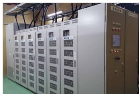
電力貯蔵装置
