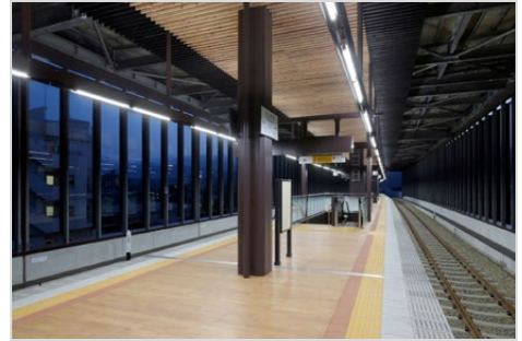
LED照明（指宿枕崎線 谷山駅）
