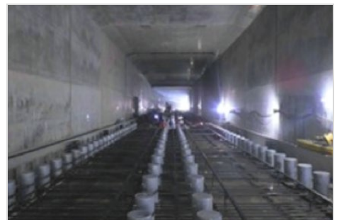
軌道スラブ内のコイルバネ (折尾駅)
