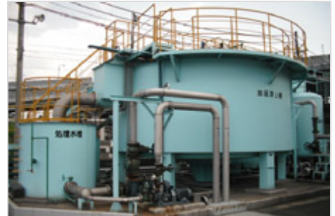
給水システム（小倉総合車両センター）
