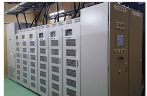
電力貯蔵装置
