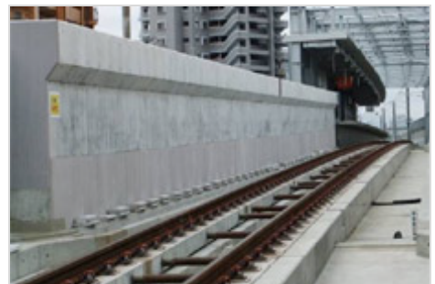
L形台座式フローティング・ラダー軌道（新水前寺駅）
