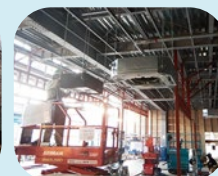
建物 × 空調点検
