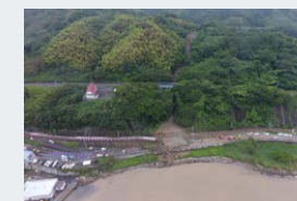
2018年7月の豪雨で被害を受けた筑肥線
