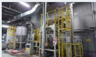
JR博多シティ内に設置された生ゴミ処理機
