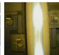
AI画像検知での ボルト緩み管理
