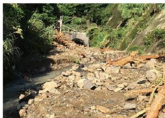
■日豊本線 津久見～日代間 土砂流入
