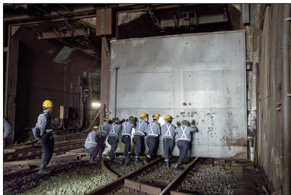
〔トンネル内防水扉の開閉〕
