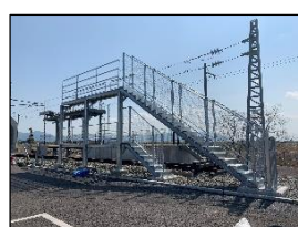
〔車両屋上機器点検台〕
