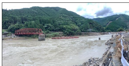
〔橋りょう流失〕
