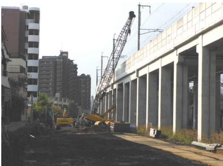
90tクローラクレーン転倒状況(起点方より)
